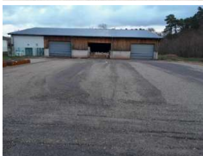
Démarrage des travaux de création d'une plateforme devant le hangar de stockage des boues
